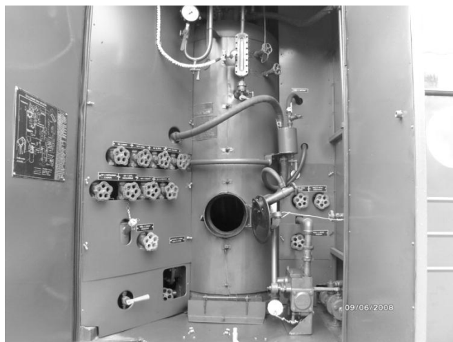
Рисунок 9.8 - Котельне відділення з котлом PI-5B
